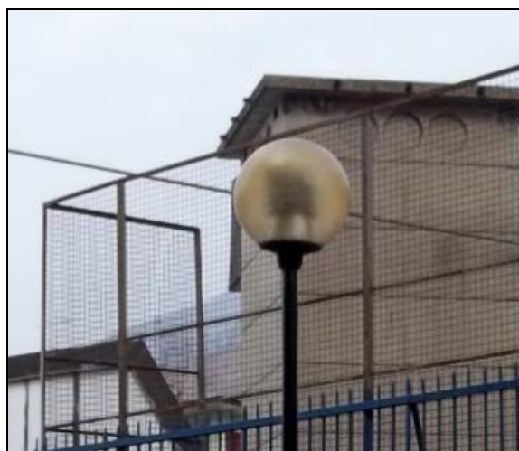
Armatura a sfera privata non conforme
