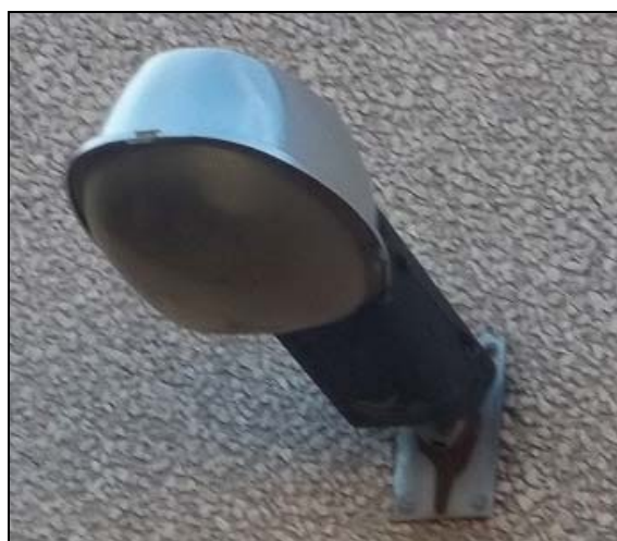
Armatura stradale privata non conforme
