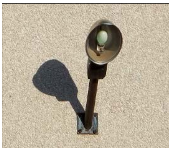
Armatura stradale privata non conforme
