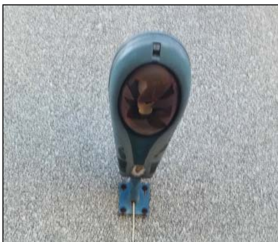
Armatura stradale privata non conforme
