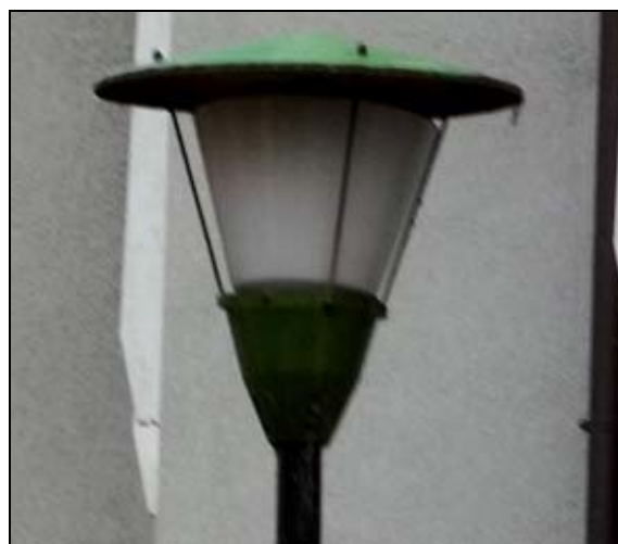
Armatura a fungo privata non conforme
