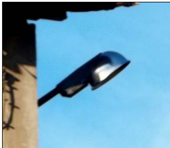
Armatura stradale privata non conforme
