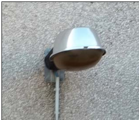
Armatura stradale privata non conforme
