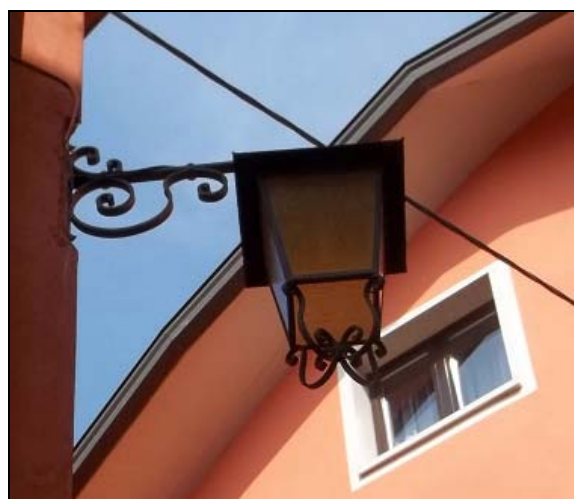
Armatura a lanterna privata non conforme
